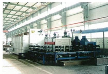
焼きなまし炉
